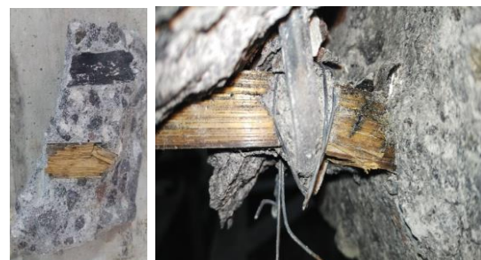
Gambar 12. Keruntuhan lekatan pada balok.
